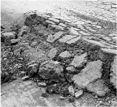
●Tuyến đường mới nâng cấp đã bị hư hỏng nặng.
