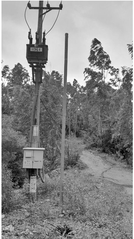
●Trạm hạ thế vào công trình trái phép của ông Hiến.
