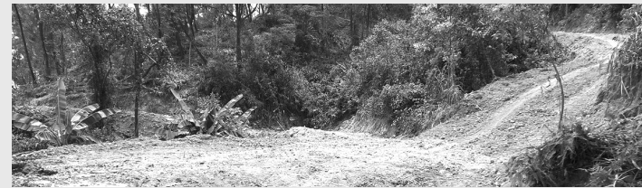
● Một số đoạn đường vào khai thác thi công sai so với thiết kế.
