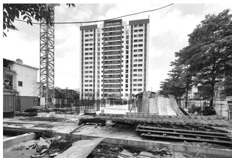
● Dự án nhận tiền đặt cọc xong chỉ thi công phần móng rồi bất ngờ dừng lại.
