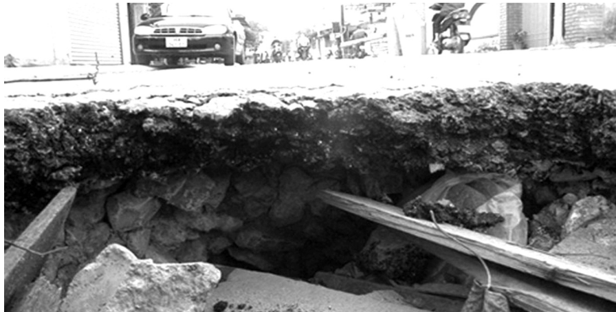
●Tuyến đường chưa được bàn giao nhưng đã xuất hiện nhiều vết sụt lún.
