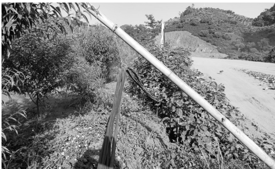
● Đường dây dẫn điện buộc tạm vào cột chống ven đường.
