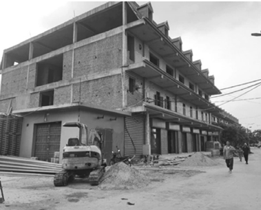
● Công trình nhà lưu tro cốt được cấp phép xây dựng 2 tầng, nhưng hiện đã được xây thành 4 tầng.
