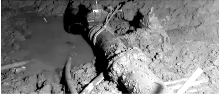
● Sự cố vỡ đường ống tạm xây ra sau khi UBND huyện Nghĩa Hưng tiến hành cưỡng chế, đã gây mất nước sạch các ngày 24, 25/5/2022.
