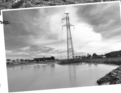
● Xung quanh chân cột điện bị đào xới gây mất an toàn.
